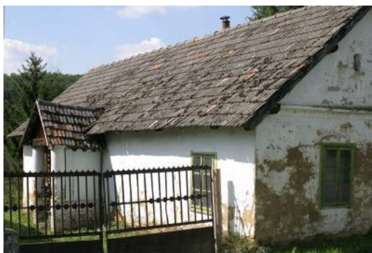
Lakóház Tömés ház kódisállással (állapota leromlott)
